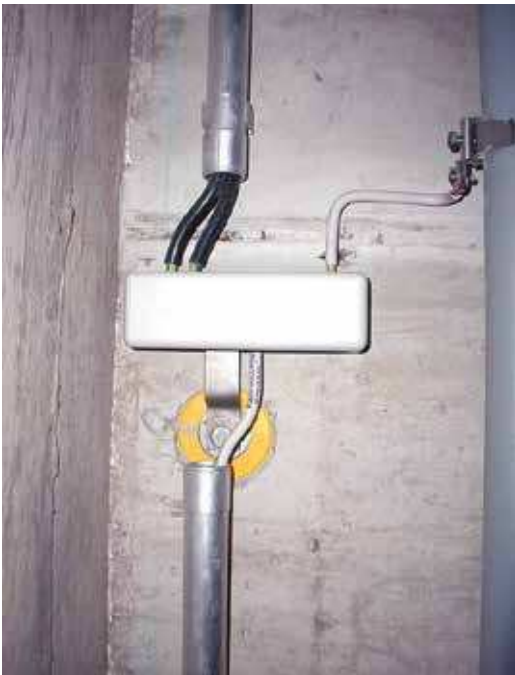
Bild 1: Haupterdungsschiene und Potentialausgleich
